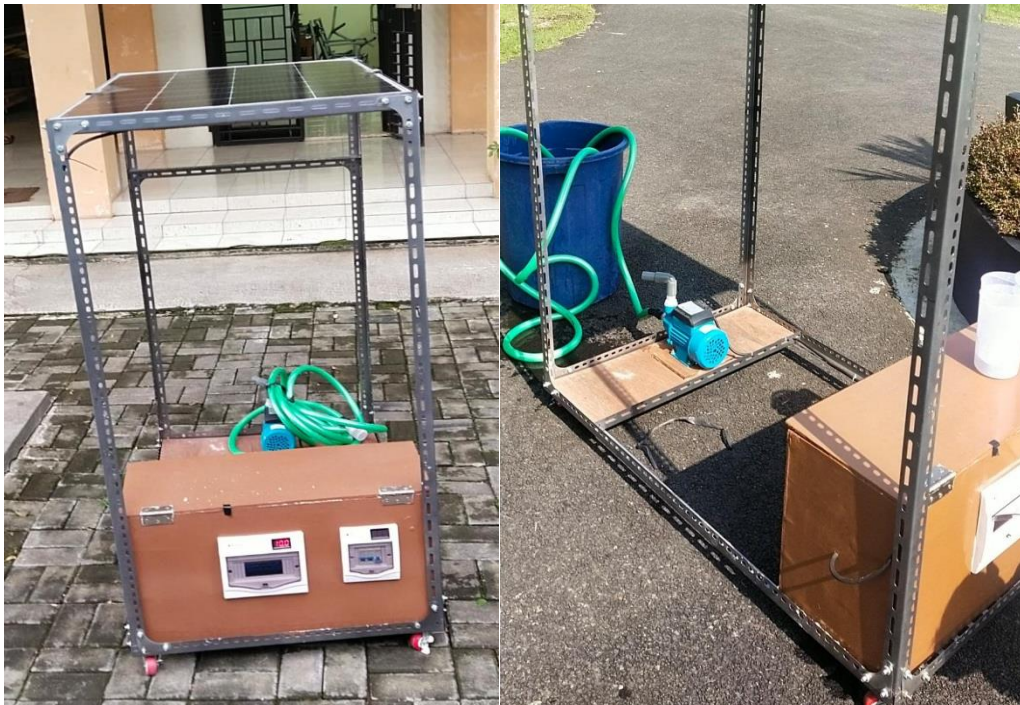
Gambar 4.1 pompa air tenaga surya dengan switch remote control
